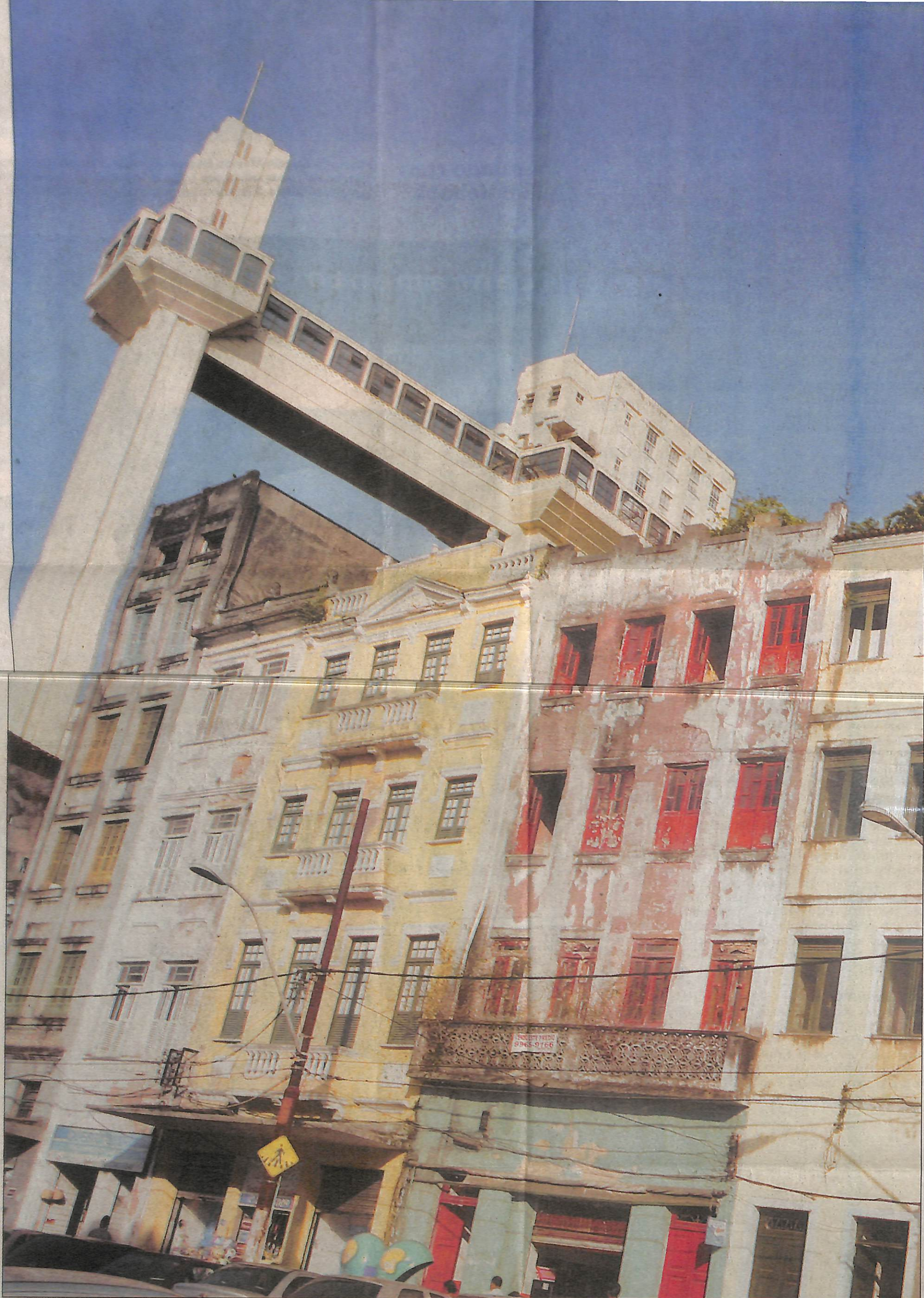
Vista dos casarões degradados ao lado do histórico Elevador Lacerda, um dos cartões-postais de Salvador. Região, há muito, precisa de cuidados
