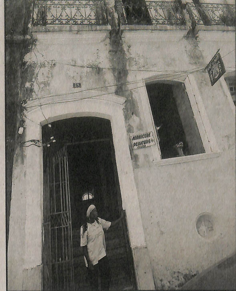
Imóvel histórico na Rua do Passo está ameaçado de desabamento
