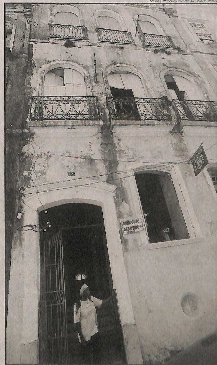
Imóvel histórico na Rua do Passo está ameaçado de desabamento
