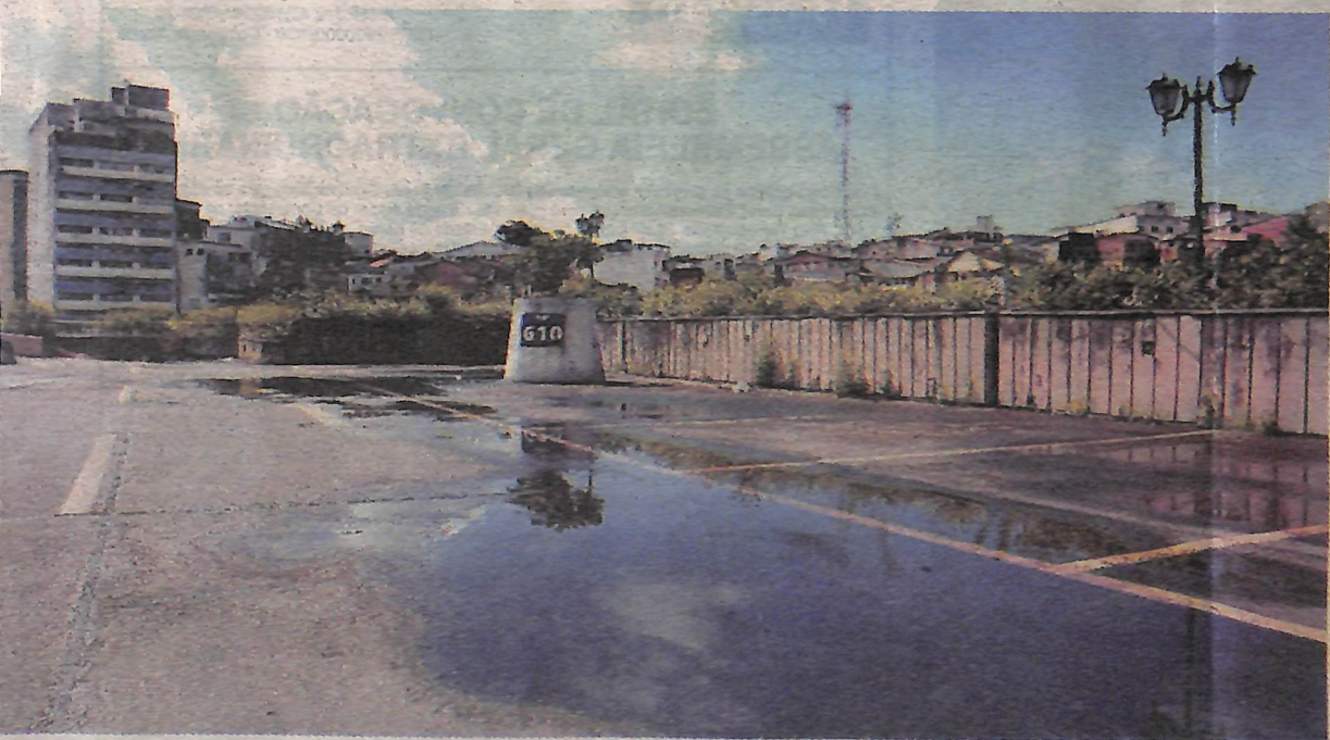
No último andar do estacionamento da Ladeira do Pax, água da chuva fica empoeçada e tem até mato
