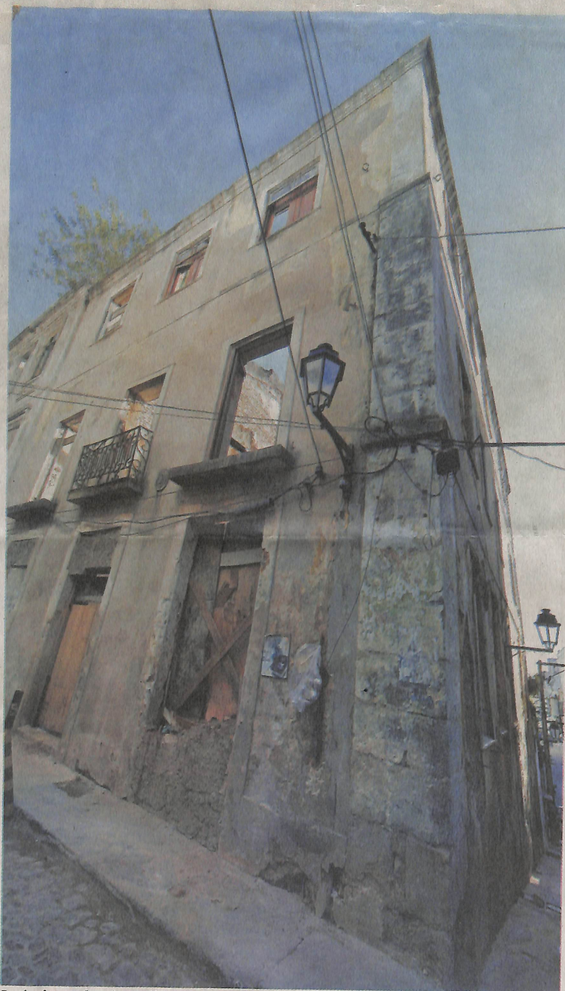
Imóveis nos locais periféricos, como esse da Rua do Bispo, precisam de manutenção
