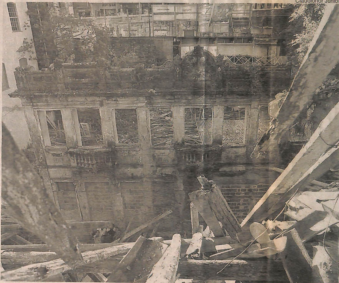
A queda do casarão na Rua Saldanha da Gama evidencia a urgência das reformas
