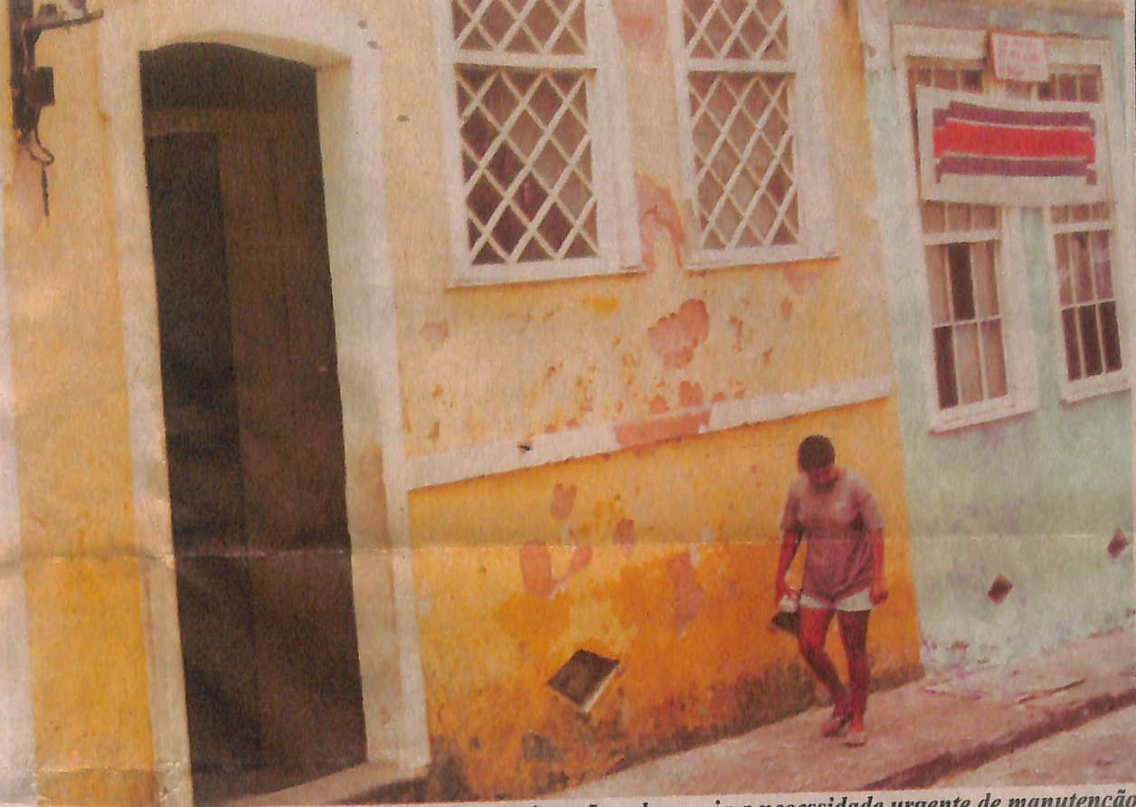
A fachada dos prédios demonstra o grau de deterioração e denuncia a necessidade urgente de manutenção
