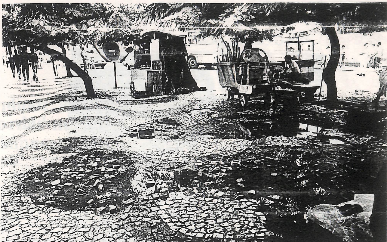
O piso de pedras portuguesas é danificado constantemente pelas barracas e não é recuperado
