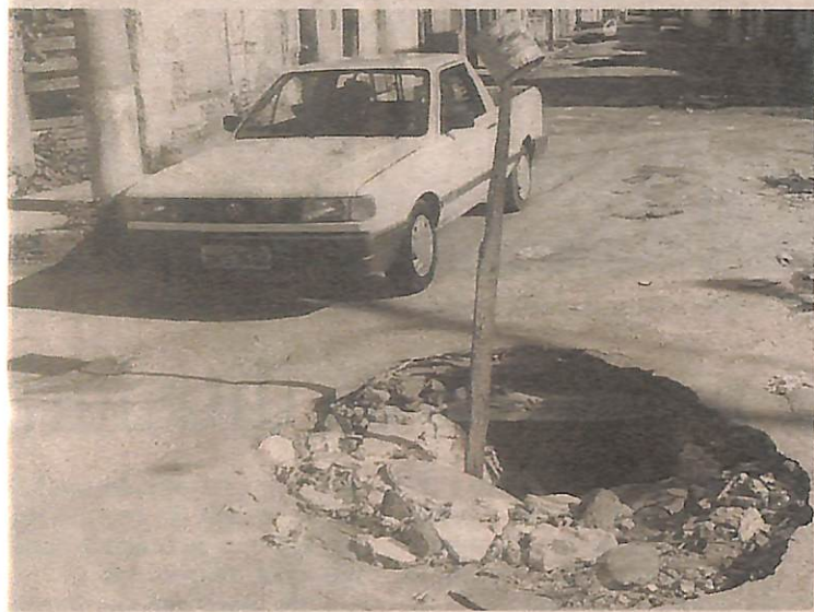
Em muitas ruas do bairro, os buracos surgem e resistem ao tempo
