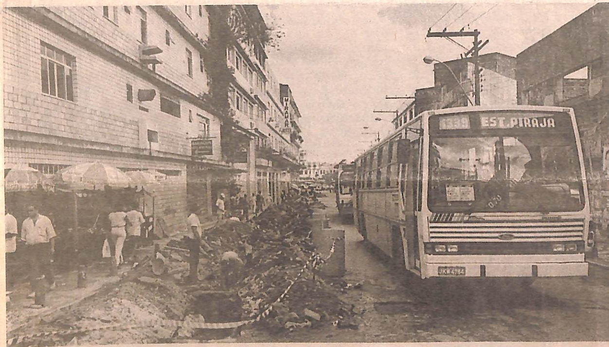
A lentidão das obras deixa as ruas atravancadas pelos buracos, prejudicando o trânsito e os moradores
