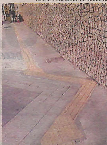
Imagem de falha postada na rede
