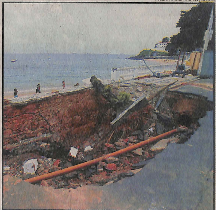
Sistema de drenagem não suporta demanda, 5 vezes maior que antes
