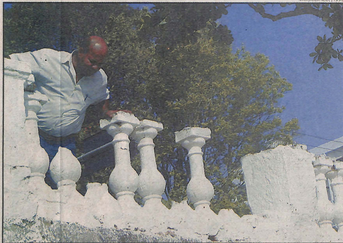
No dia em que caiu, a balaustrada dava margem a acidentes: prazo da obra, após permissão, é de dez dias
