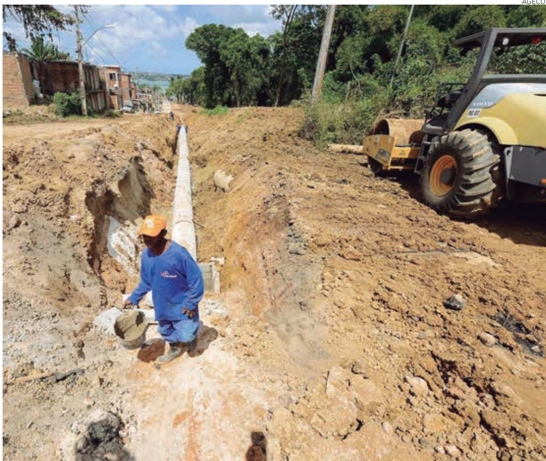
Além das encostas, foram vistoriadas as obras de pavimentação e drenagem da Rua Eduardo Dotto
