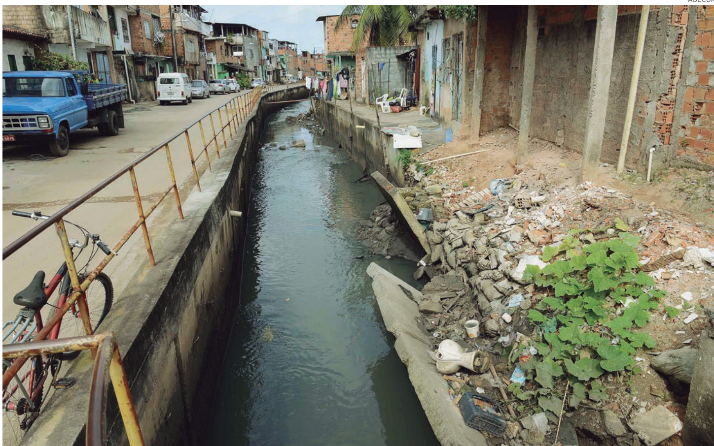
O Canal do Pistão, no Uruguai, que está com placas de contenção soltas e trechos em estado de erosão em frente às residências, será recuperado
