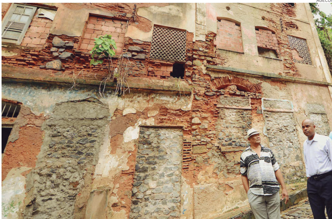
No Taboão há casarões nas condições deste da foto. A Prefeitura alerta os moradores para deixarem os locais
