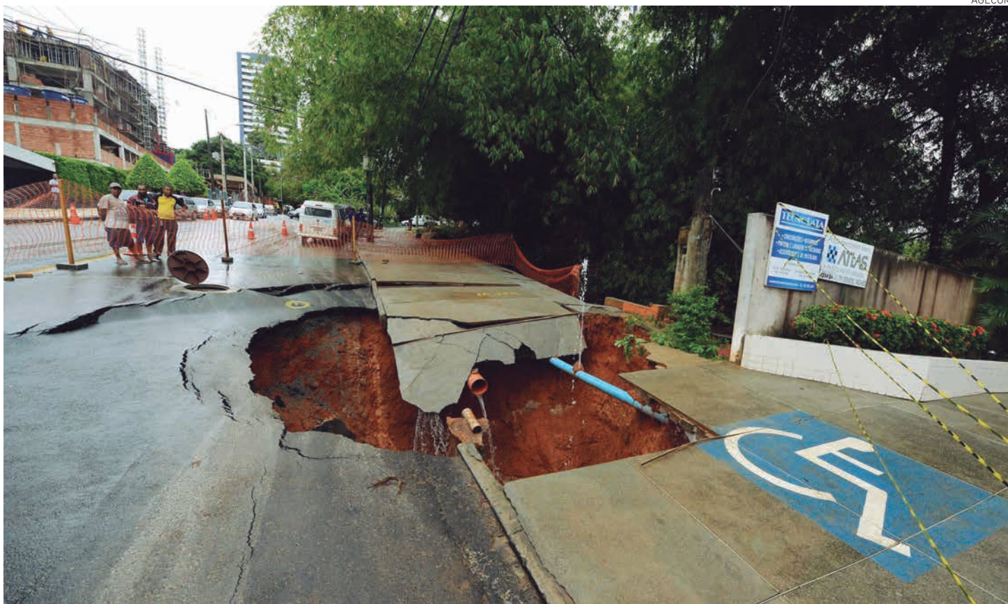
O asfalto cedeu no bairro Cidade Jardim e abriu uma cratera próximo a um prédio em construção. Uma das pistas foi interditada pela Transalvador
