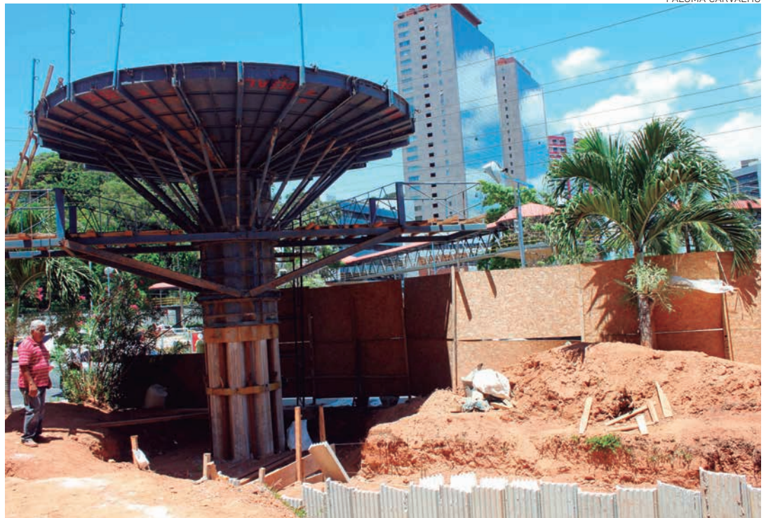
Depois do término das obras, os semáforos serão desativados, dando mais fluidez ao tráfego da movimentada região
