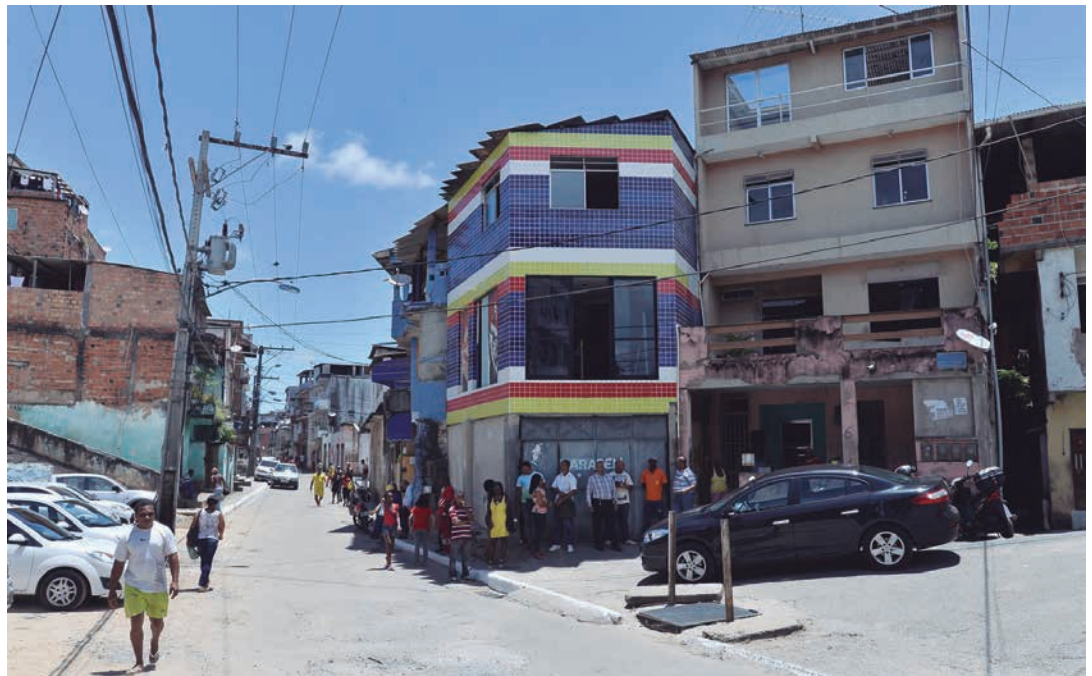
Obras de infraestrutura da Rua do Gás começam na próxima segunda-feira e deverão ser concluídas em 90 dias
