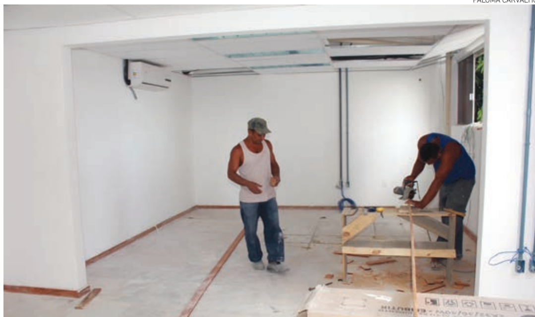
Em fase final de construção, a expectativa é de que o prédio seja inaugurado até o dia 20 de setembro
