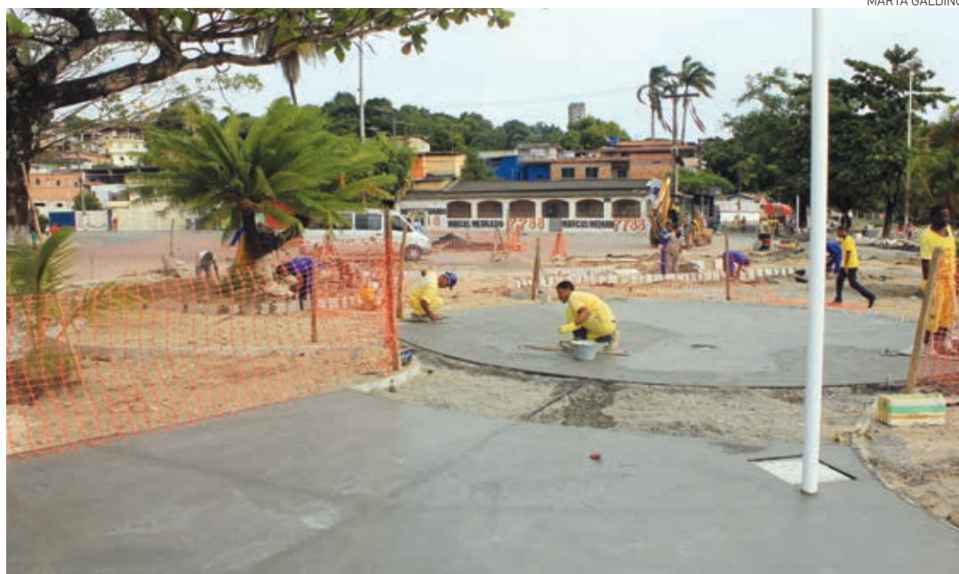
Em São Tomé de Paripe já foram finalizadas as obras de drenagem, pavimentação e recuperação da alvenaria
