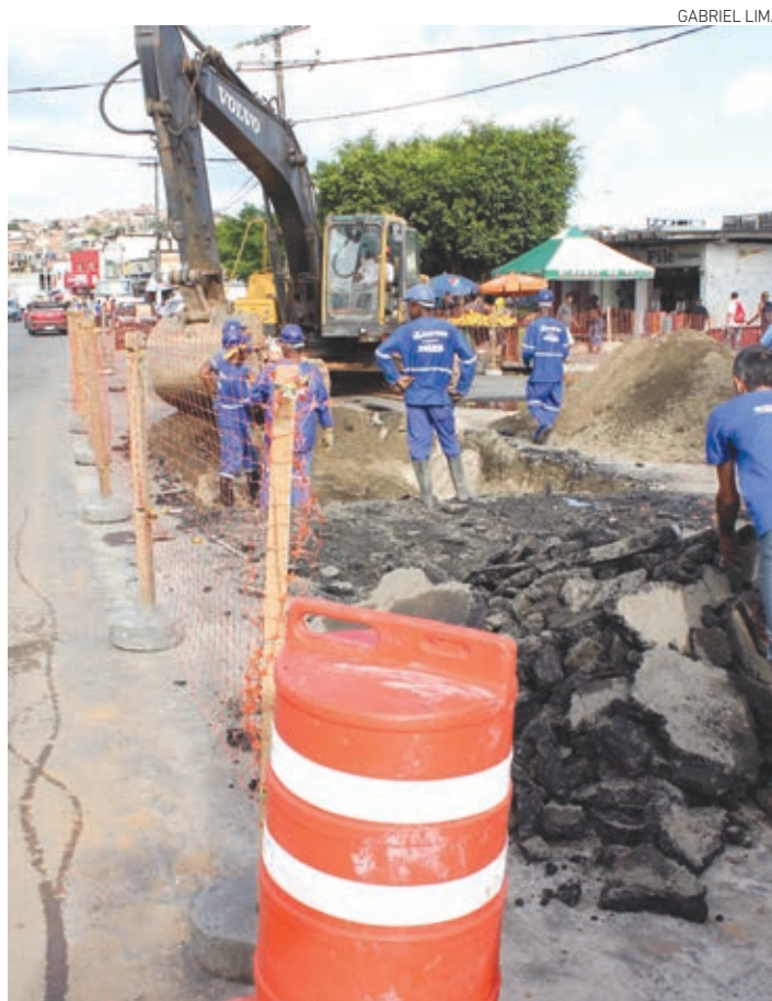
Após a realização de obras, a Embasa não faz reparos nas vias com qualidade
