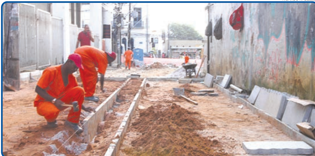
No Beco Maria Paz foi feita a recuperação do sistema de drenagem e a etapa seguinte é aplicação do piso
