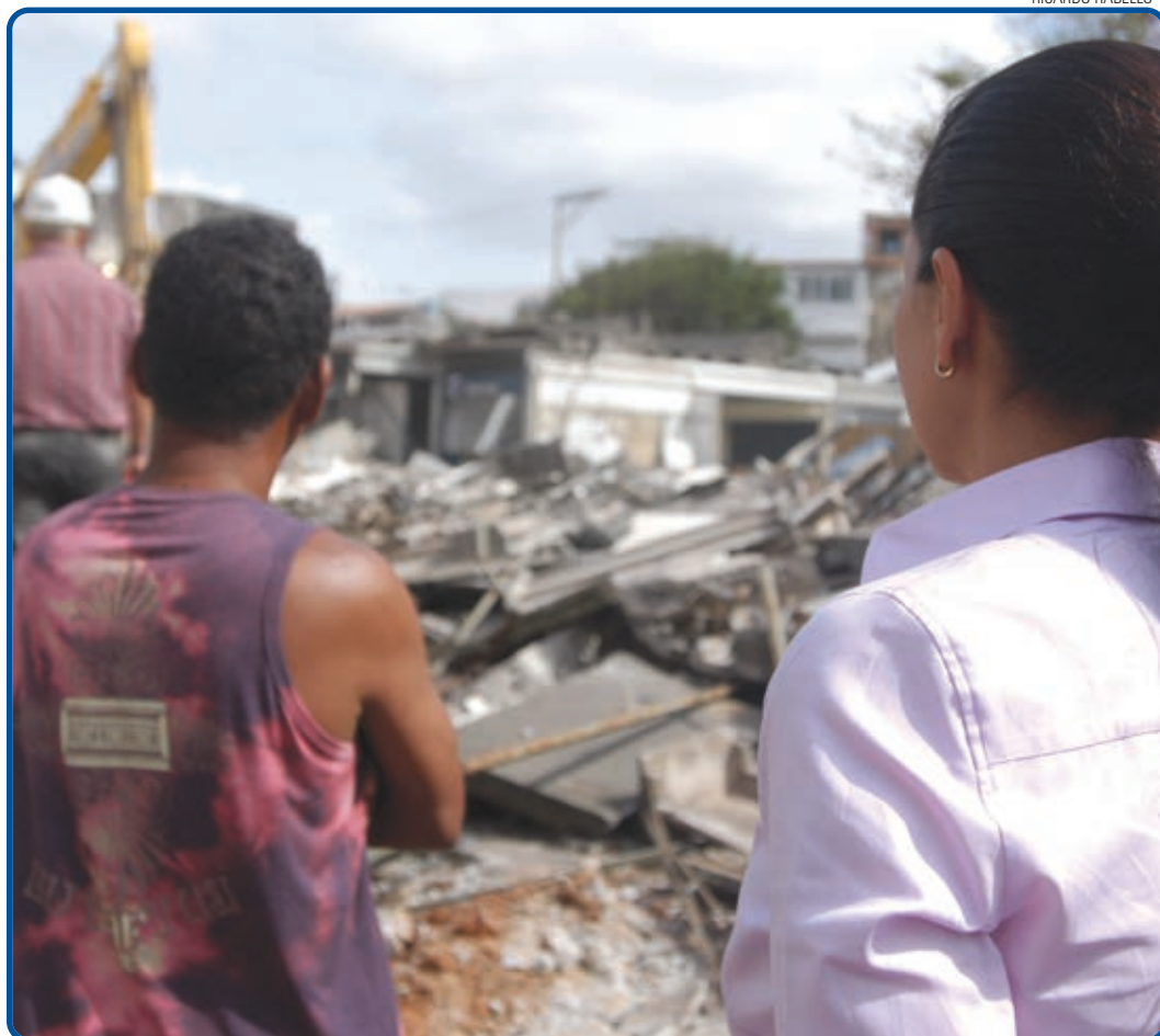
A demolição foi executada pela Sucom, e as obras de construção do novo prédio ficarão a cargo da Sucop
