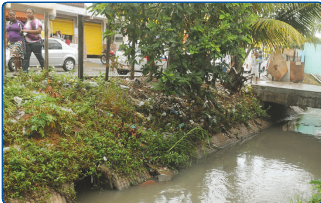
Será realizada uma ação emergencial de limpeza do canal do Vale das Pedrinhas, que provoca alagamentos
